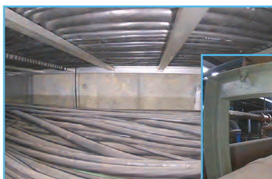
▲ケーブルラックの隙間
